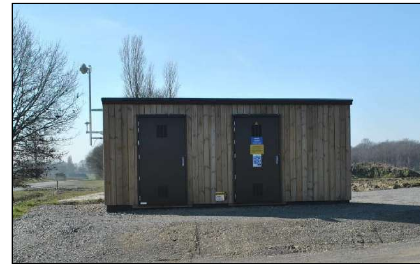
Photographie 43 : Exemple de bardage bois sur un poste de livraison.
