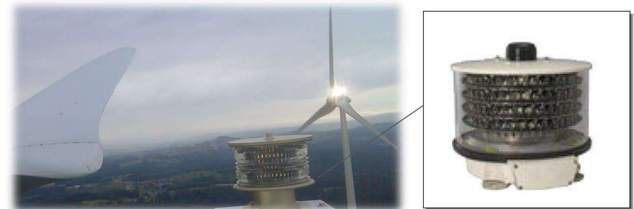
Figure 33 : Balisage d'une éolienne.
